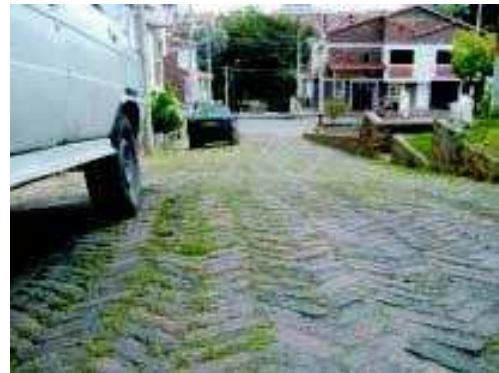
Foto 9. Desplazamiento de juntas
