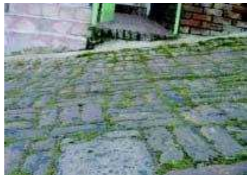
Foto 5. Desplazamiento de juntas
