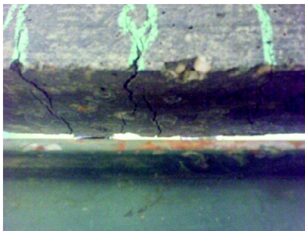
Fig. 34. Fisuras del concreto por esfuerzos de tensión
