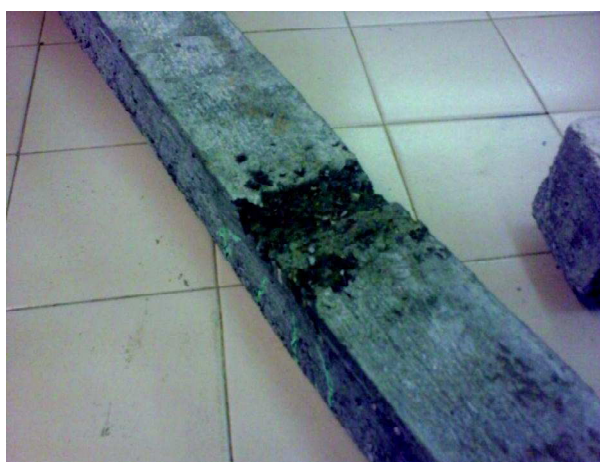
Fig. 36. Resquebrajamiento o descascaramiento del concreto por falla a compresión
