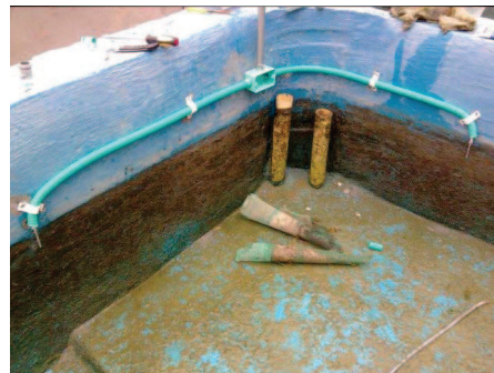
FIG. 15. Instalación termocuplas tipo J
