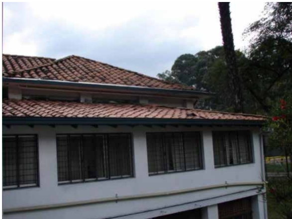
FIG. 1. Cubierta para captación de aguas lluvia. Fuente: Medina, C.
