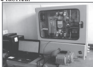
Figura 4. Módulo con variador de velocidad industrial CFW-11. Fuente: los autores.
