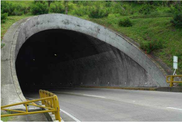
Figura 5. Túnel de Dosquebradas (Autopista del Café, entre Dosquebradas y Santa Rosa de Cabal, departamento de Risaralda).
