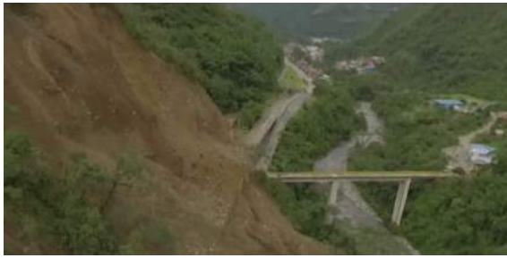
Figura 3. Derrumbe en vía Bogotá-Villavicencio; (Fuente: Captura video Noticias Caracol).
