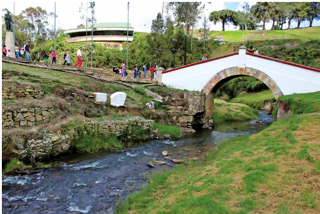
Imagen 7. Puente de Boyacá: se aprecian: el deterioro de los estribos de soporte, de los muros de contención construidos en el cause del río Teatinos que amenazan derrumbarse; de canaletas, tubos de desagüe y protectores de reflectores de luz, en mal estado. Fotografía: Hans Christian Wiesner Moreno.
